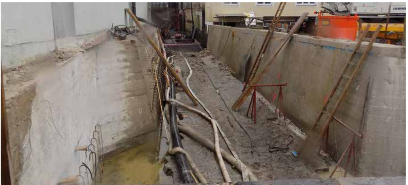
Eine der letzten Arbeiten für den HW-Schutz: Hier am Marbach im Bereich der Bundesstraße.
